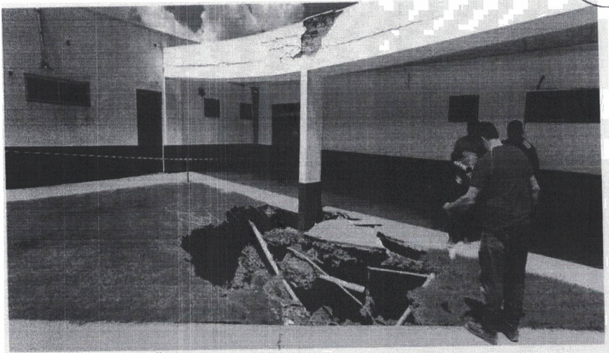
Figura 01: Afundamento do pilar.
