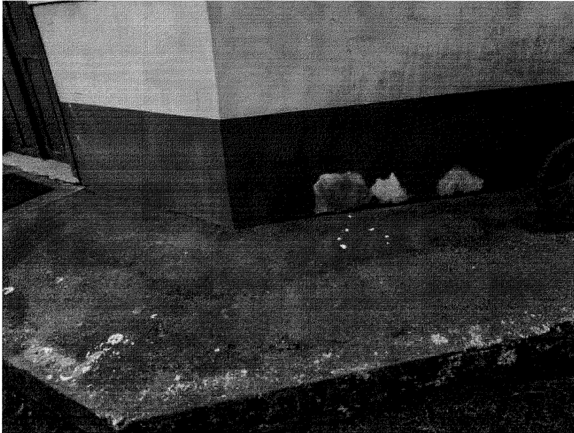
Pintura precisando de reparos. Em 22/09/2021.
