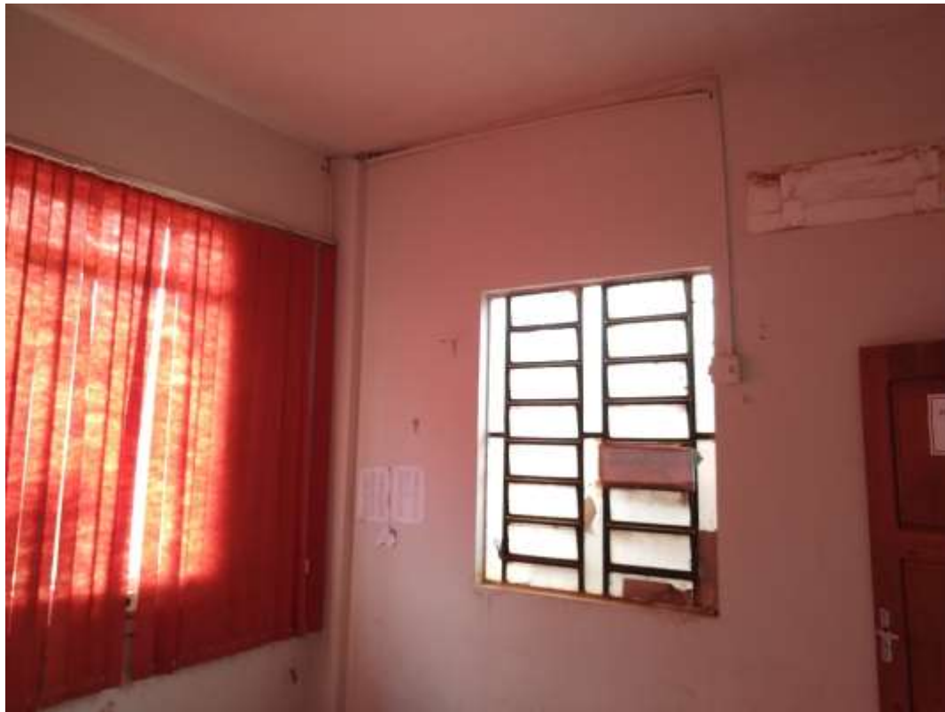
Figura 03 – Janela de vidro danificada, sala 1.
