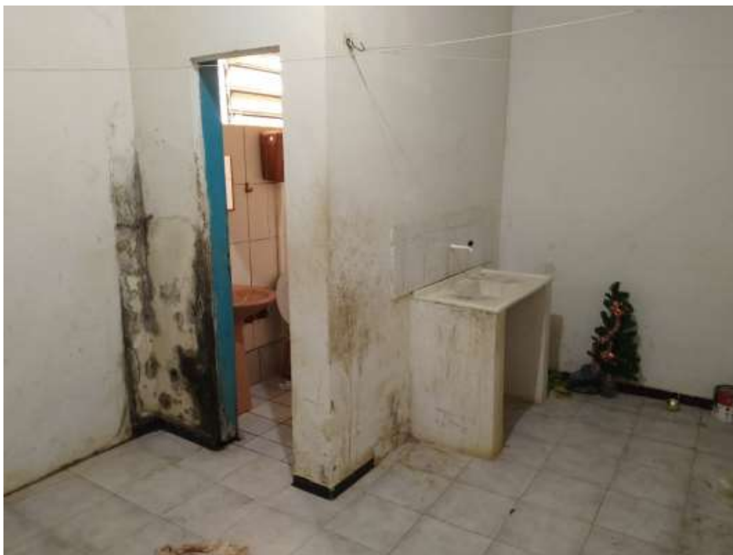
Figura 02 – Patologia gerada por infiltração e umidade, área serviços.
