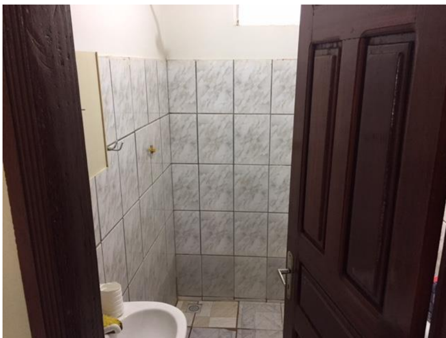
Figura 04 - Instalações do banheiro 1 presente na edificação.
