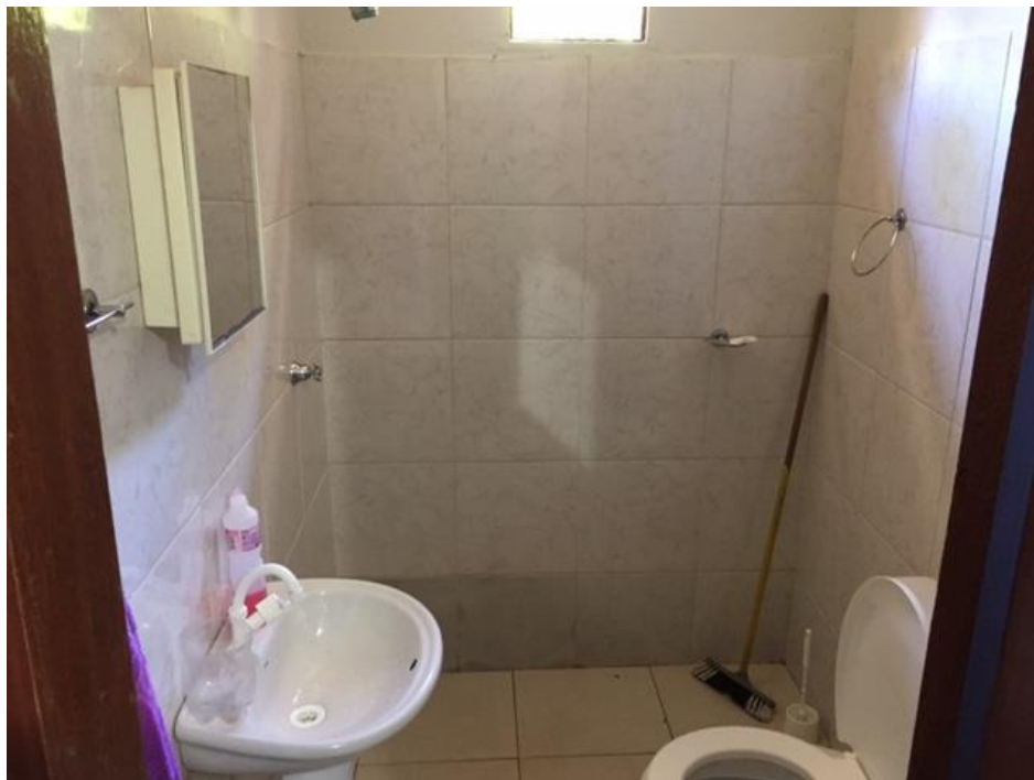
Figura 05 - Instalações do banheiro 2 presente na edificação.
