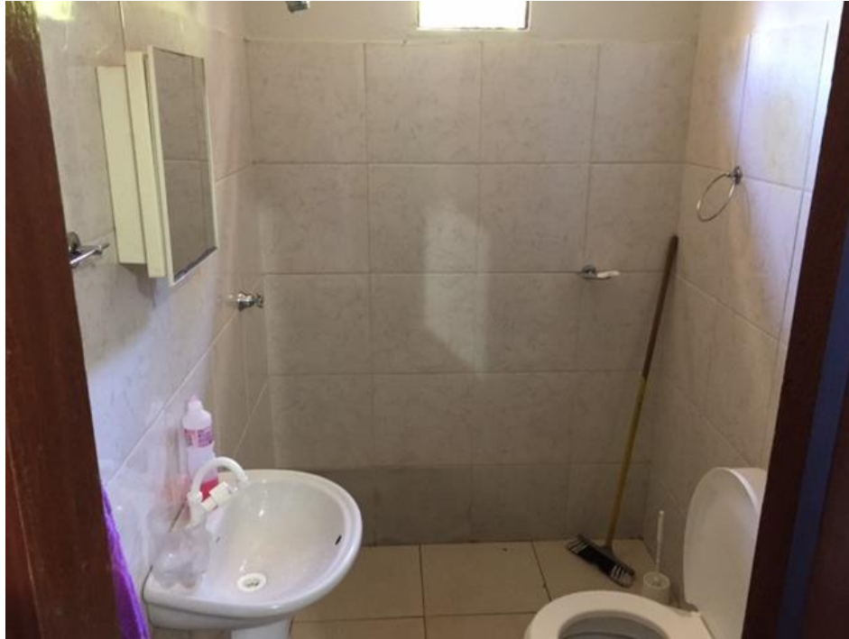
Instalações do banheiro 2 presente na edificação.
