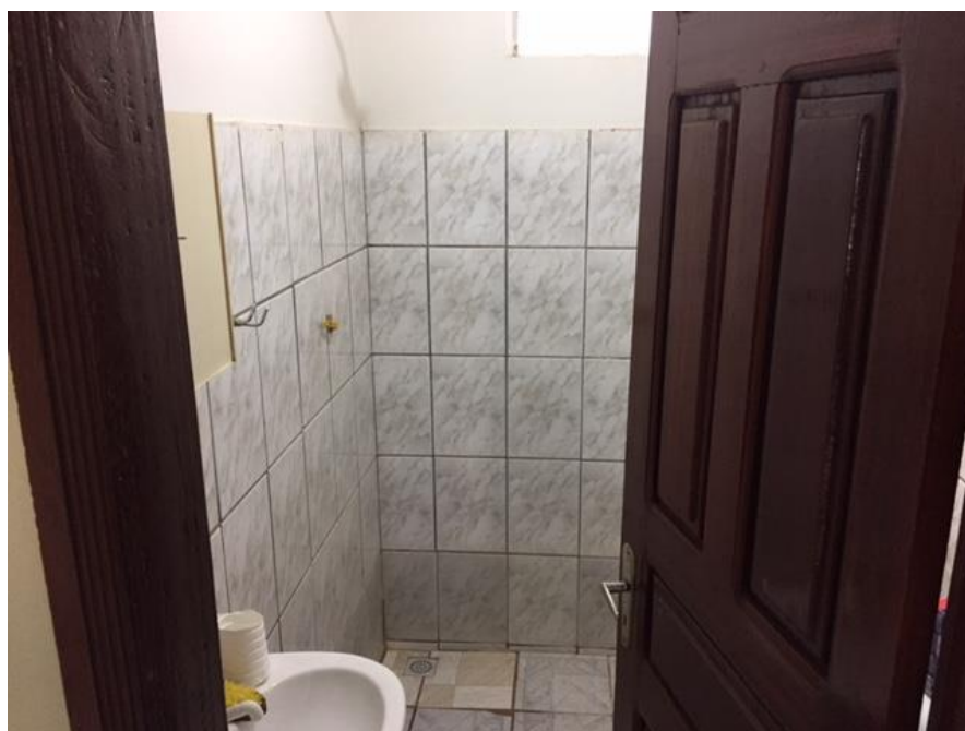
Instalações do banheiro 1 presente na edificação.
